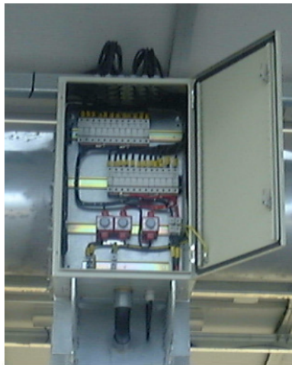
FIGURA 6.12: Caja de protección DC. Incluye dos fusibles por rama y varistores entre polos y tierra
